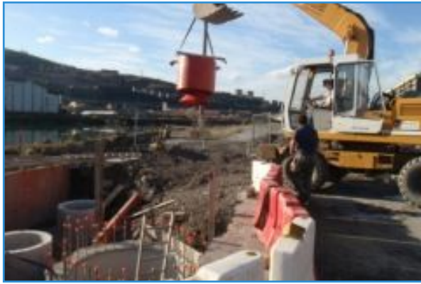
El equipo de separación es izado para colocarlo en su ubicación definitiva junto al Canal de Deusto.
