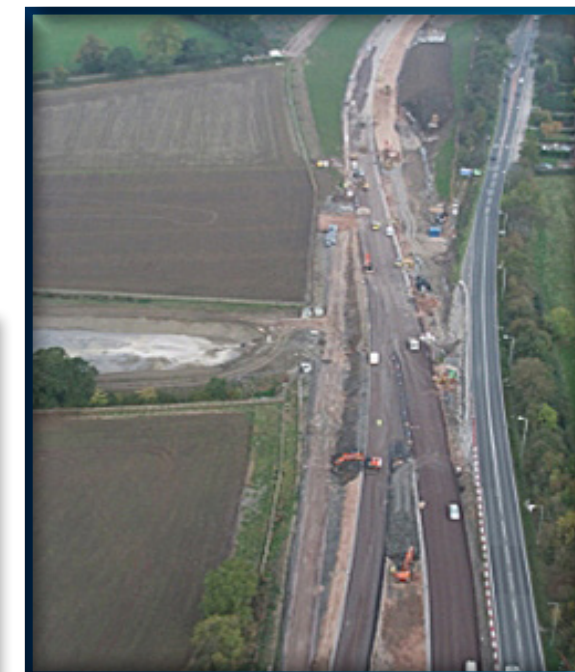
Fig5: SUDS en la mejora de la autopista A46 en UK. El proyecto incluyó 12 balsas con válvulas reguladoras de caudal Drenatura Hydro-Brake®.
